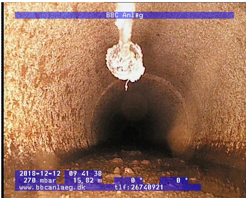
Bar. Margrethes Vej 1; Betonbrønd \varnothing 60 cm. Foto af drænrør 15,82 m fra brønd på grund mod vest og med bundgrus/jord.
