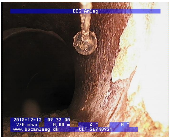
Bar. Margrethes Vej 1; Foto i betonbrønd Ø 60 cm på grund. En del bundgrus/jord i bunden af brønden (90 grader sving) og i røret ud under vejen.
