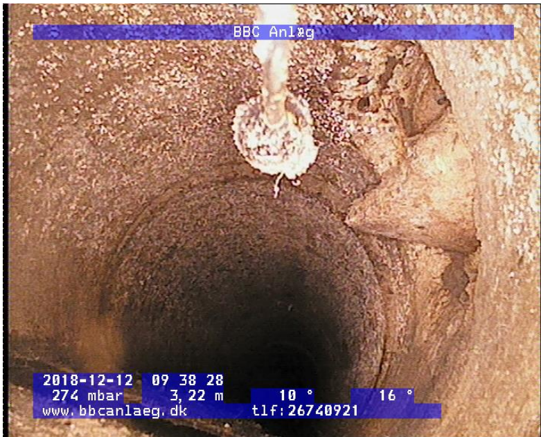
Bar. Margrethes Vej 1; Betonbrønd \varnothing 60 cm. Drænrør med siderør 3,22 m fra brønd på grund mod vest og med bundgrus/jord.
