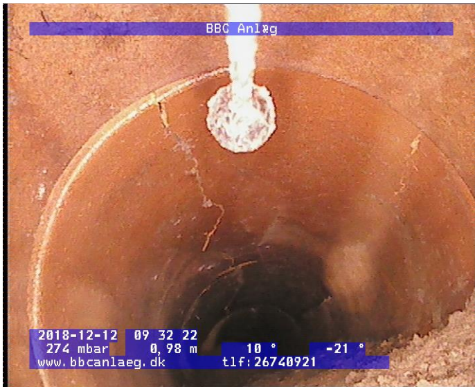
Bar. Margrethes Vej 1; Betonbrønd Ø 60 cm. Drænrør under vejen er revnet – 0,98 m fra brønd. En del bundgrus/jord i bunden af røret.
