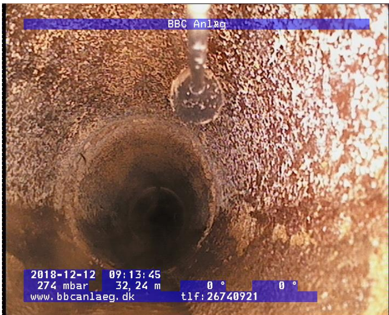
Bar. Margrethes Vej 4; Sydlig brønd: Foto i rør mod syd 32 m, endnu en ny brønd (15 m mellem brønde) kommer til syne hos Bentsensvej nr. 5.
