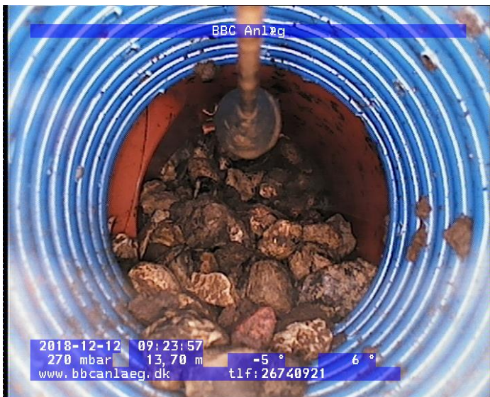
Bar. Margrethes Vej 4; Sydlig brønd: Foto i brønd mod nord-øst hos nabo (BMV nr. 6). Nabodrænrør med mindst 4 siderør slutter med dette siderør med stenfyld!.
