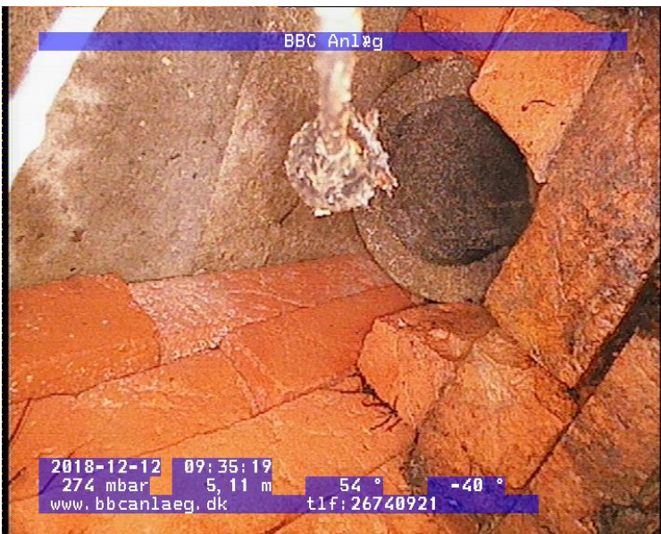
Bar. Margrethes Vej 4; Beton/opmuretbrønd 5,11m fra betonbrønd BMV nr. 1 på modsat side af vejen. Sidedræn fra grund til brønden.
