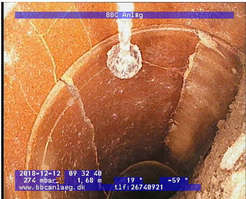
Bar. Margrethes Vej 1; Betonbrønd Ø 60 cm. Drænrør under vejen er revnet 1,68 m fra brønd. En del bundgrus/jord i bunden af røret.
