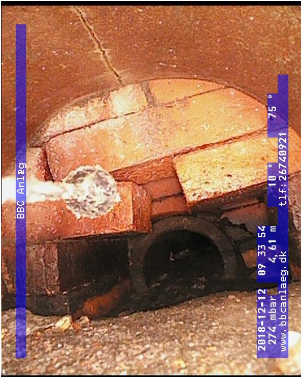
Bar. Margrethes Vej 4; Beton/opmuretbrønd 4,61m fra betonbrønd BMV nr. 1 på modsat side af vejen. Drænrør under vejen er revnet. En del bundgrus/jord i bunden af røret.
